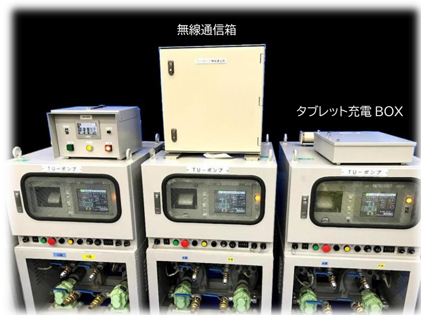
(無線通信箱とタブレット充電 BOX)
