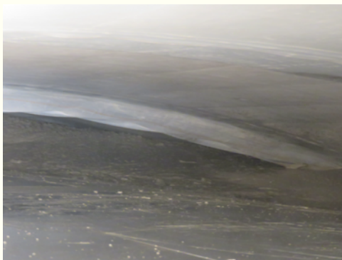
FILM シート現場溶着部のたるみ状況
